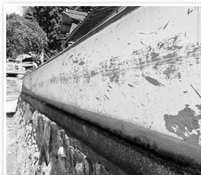
水位の高さを物語る外壁
